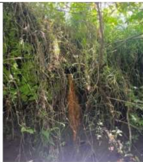
Figura N°6. Tubería particular existente (de terceros). Fuente: Propia (2023).
