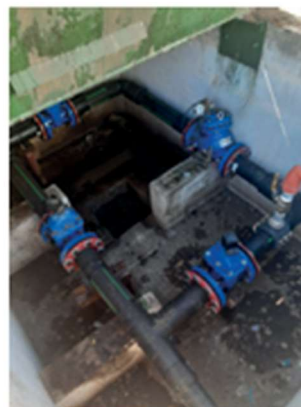
ESTACION DE PRESIÓN
