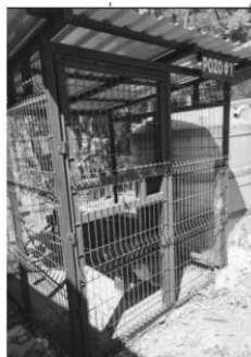
Fotografía 9. Pozo de abastecimiento de agua #1
