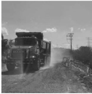
Fotografía 24. Nubes de polvo que se generan al transitar los vehículos por los caminos internos. SEXTO: La segunda visita realizada el 28 de febrero del 2024 se realizó en el Residencial Bosques de Doña Rosa, con vista hacia el PTA la Uruka, para observar la cobertura de los residuos al inicio de la jornada (fotografía 25)
