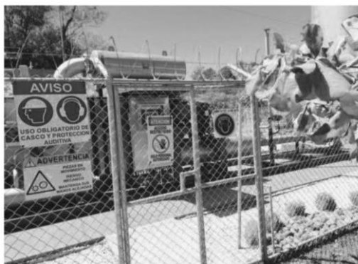
Fotografía 2. Sistema de extracción de biogás (SKID) en funcionamiento
