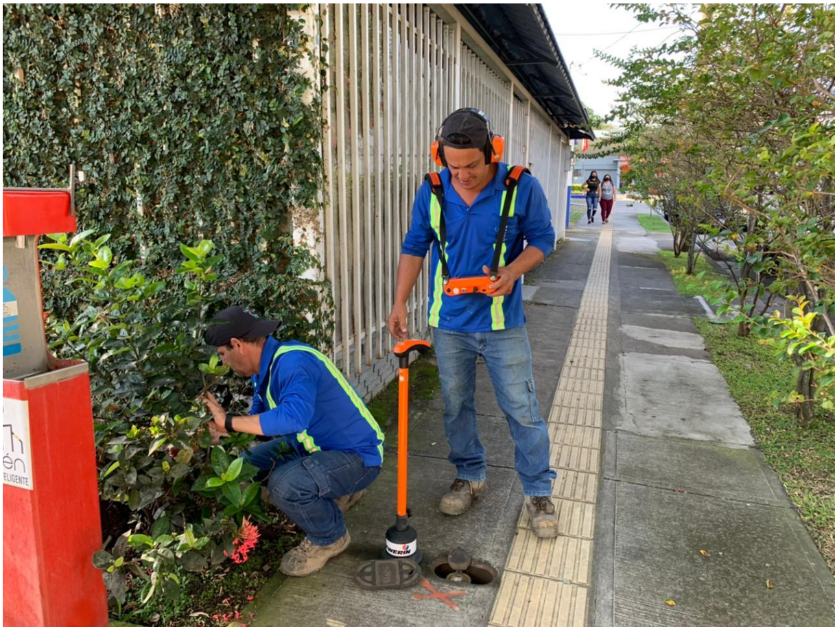
Figura N°23. Atención de las fugas del Edificio Principal. 2021.
