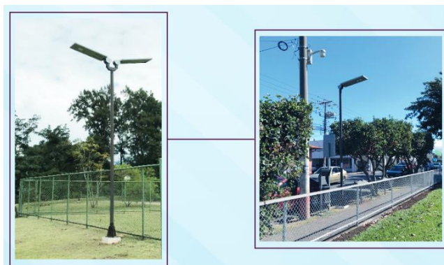
Figuras N°79 y 80. Luminarias solares. 2021.
