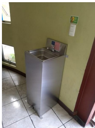
Figura N°25. Lavamanos en edificios municipales. 2021.
