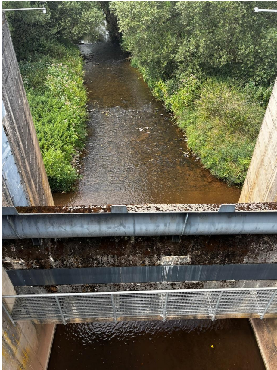
Fotografía 12. Sistema de retención del río. Ottweiler.
