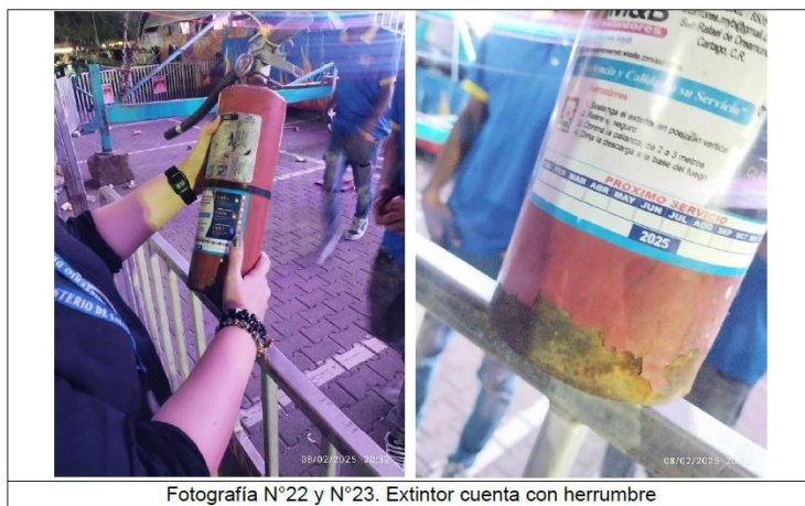
Fotografía N°22 y N°23. Extintor cuenta con herrumbre
