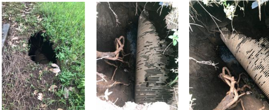
Orificio de 50 cm en terreno por daño en tubería. Fotografía 22 de octubre de 2022. Nota presentada a la municipalidad en 2022.
