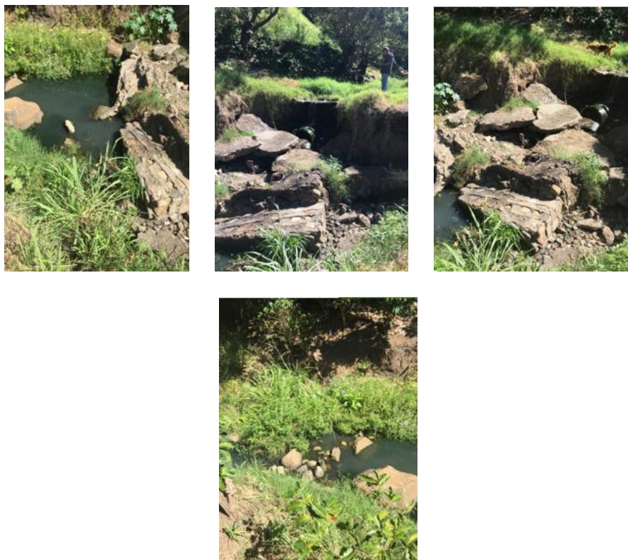
Puente destruido por el exceso de escorrentía. Fotografía 11 de enero de 2020. Nota presentada a la municipalidad en enero 2020.
