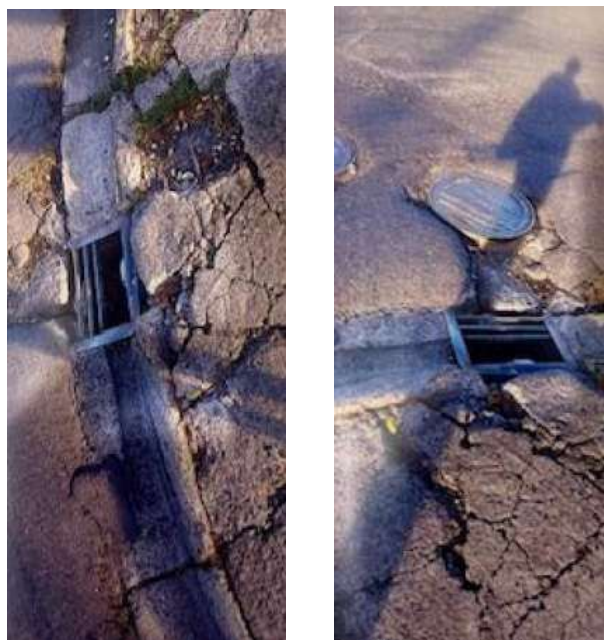
Trámite 2680-2024 – Sifones vertiendo aguas residuales en vía pública.
