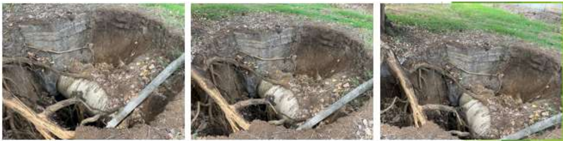
Orificio de 4,50 mts en terreno por daño en tubería. Fotografía 22 de abril de 2025.
