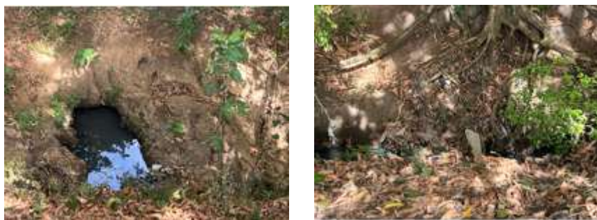
Estado del canal y aguas provenientes del sistema municipal. Fotografía del 22 de abril de 2025.
