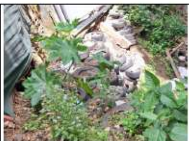
Figura 3 En el sitio se observa una obra de llantas que colapsó.
