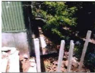
Figura 2: El talud es de cerca de 5 metros y la estructura está al borde.
