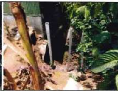
Figura 3: Se observa parte de los cimientos en el aire tras el desprendimiento en la parte alta del talud.
