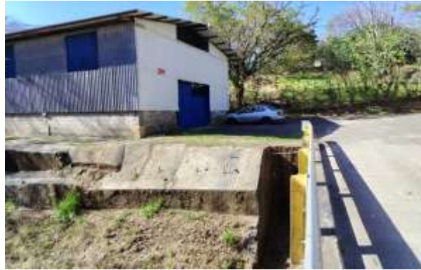
Figura N°2. Fotografía general del área a intervenir para la posible instalación de tuberías pluviales y sanitarias dentro de la Servidumbre. Fuente: Propia, Municipalidad de Belén.
