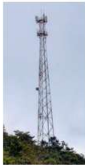
Torres de telecomunicaciones
