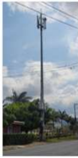
Postes de telecomunicaciones
