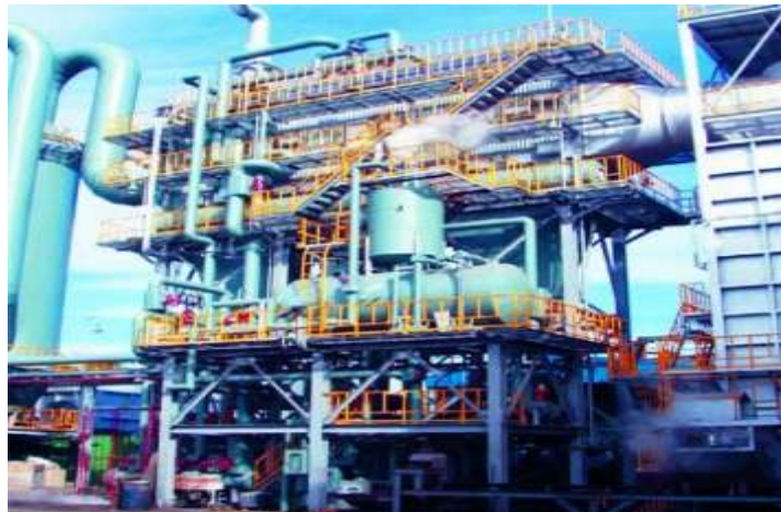
PLANTA DE INCINERACIÓN
