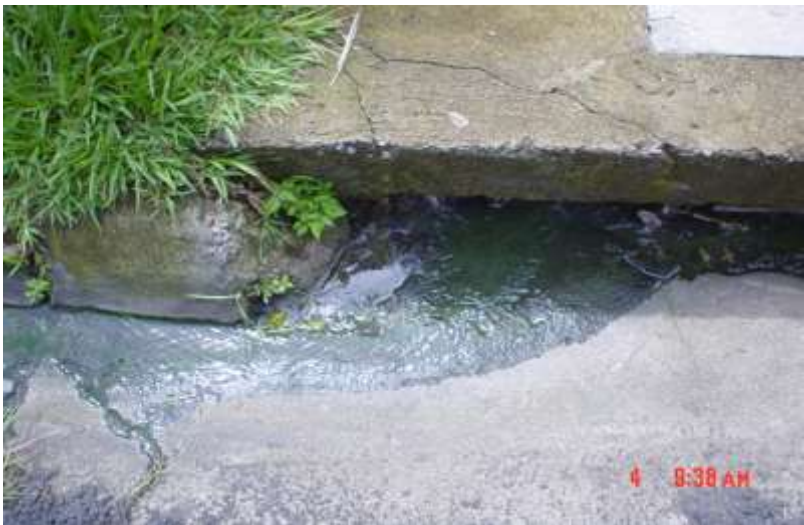
Tanque séptico en EBAIS, B° Escobal Distrito de San Antonio
