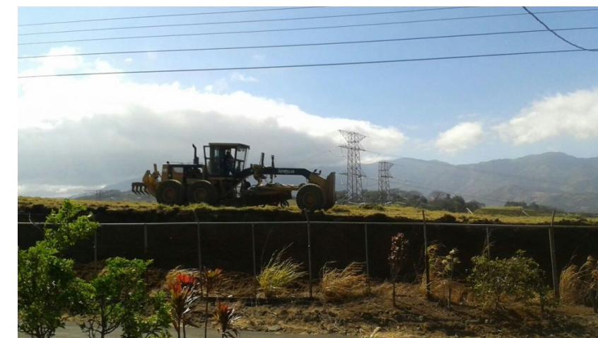
Movimientos de tierra realizados por Pedregal en la zona de protección del acuífero Puente Mulas para construir una calle. El Guacho/2017
